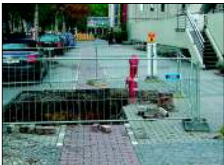
Falsch und gefährlich: Eine Baugrube, die nur mit einem Bauzaun gesichert ist, lässt sich ...
