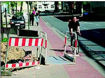
Das Gelände auf dem Brückenelement reduziert die verbleibende Breite. Besser wäre der Einsatz einer Abdeckplatte, die vom Radverkehr überfahrbar ist.
