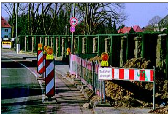
Gehweg neben Radfahrstreifen: Der Fußgänger wird alleine gelassen, der Radfahrer soll das kurze Stück schieben. Hier fehlt eine Absenkung für Rollstuhlfahrer, der Radfahrstreifen kann als „Gehweg, Radfahrer frei“ von Fußgängern und Radfahren genutzt werden.
